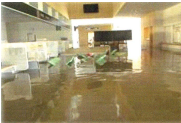
庁舎1階の浸水の様子(常総市)
